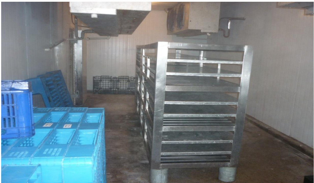
Figura 27 - Túnel de congelamento da agroindústria.
